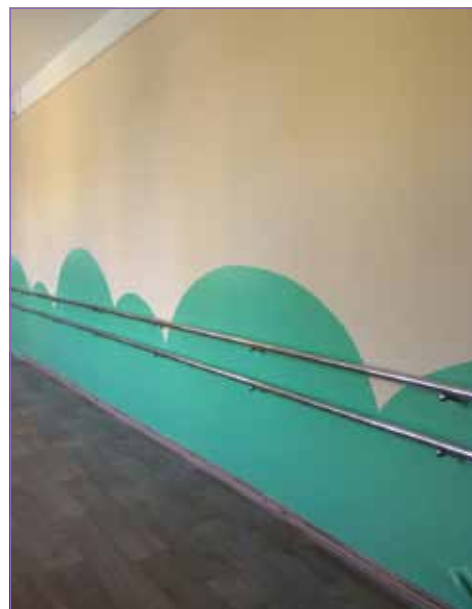
Внутри здания вдоль стен установлены поручни для детей
